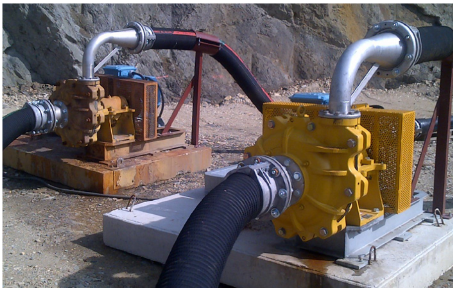
EMW slurry pumps
